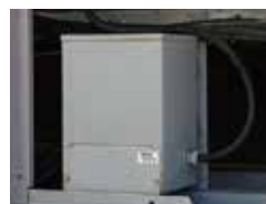
変圧器・変流器
