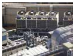
屋上・屋外空調機
