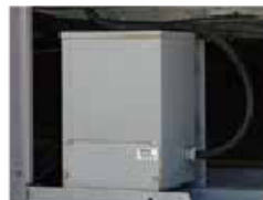
変圧器・変流器
