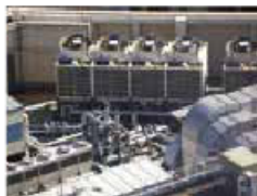
屋上・屋外空調機
